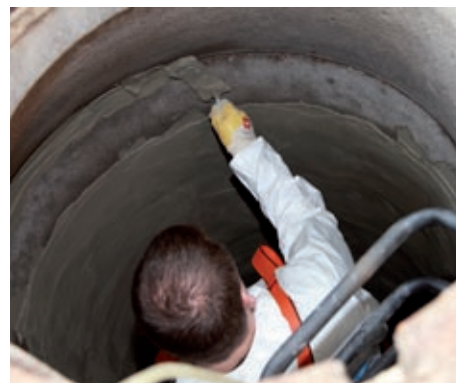
Uszczelnienie na łączeniu kręgów studzienek
