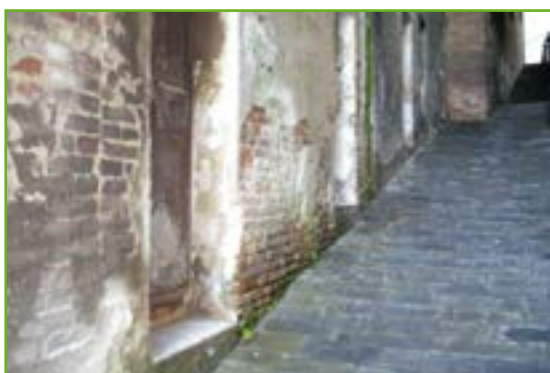
Zniszczenie wypraw tynkarskich i spoin w murach
