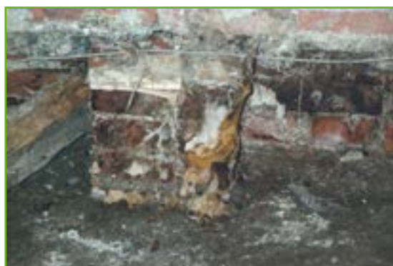
Porastanie pleśnią, rozwój grzybów, uszkodzenie substancji budowlanej
