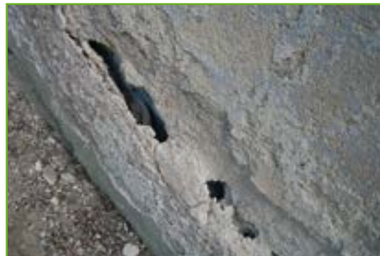
Odsapające się tynki
