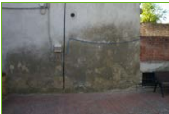
Odbarwienia powłok malarskich, utrata termoizolacyjności
