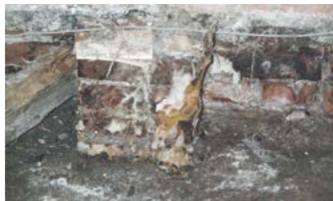
Powstawanie korzystnych warunków rozwoju grzybów i pleśni oraz do zniszczenia samej substancji budowlanej
