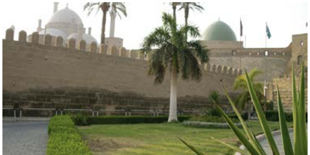
Przykład podciągającej wilgoci
