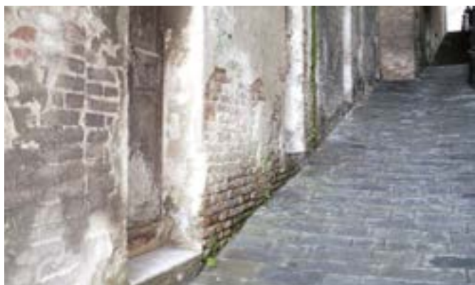
Zniszczenia tynków i spoin w murach
